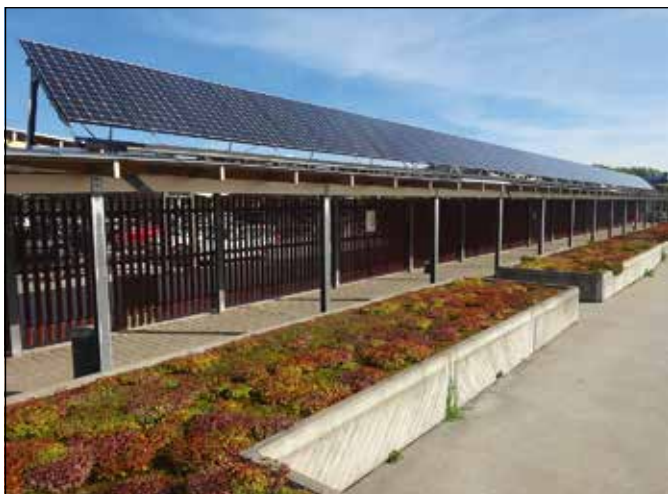
Solceller placerade på utvändig arkad, Tekniska verken.
