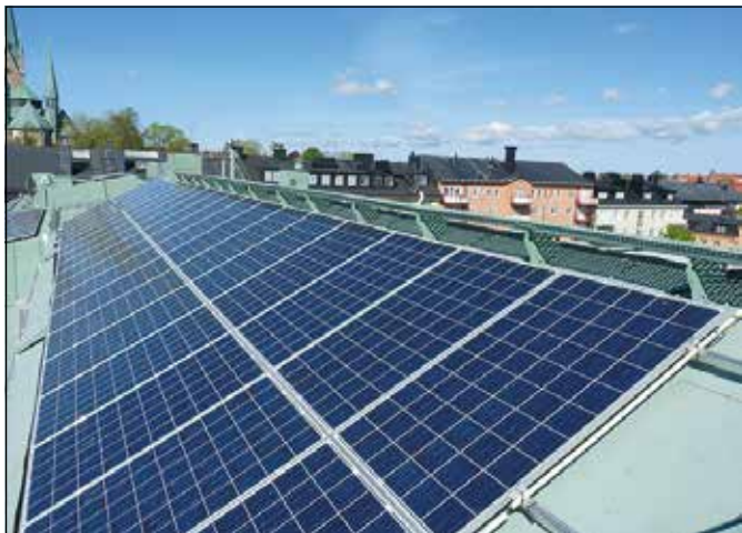
Solcellsanläggning i centrala Linköping. Anläggningen är högt placerad och syns inte från gatan.
